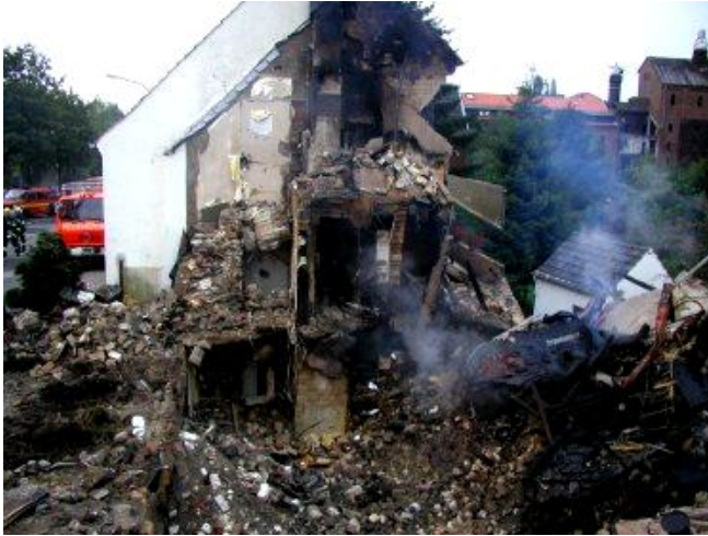
Abbildung: Haus nach einer Gasexplosion
